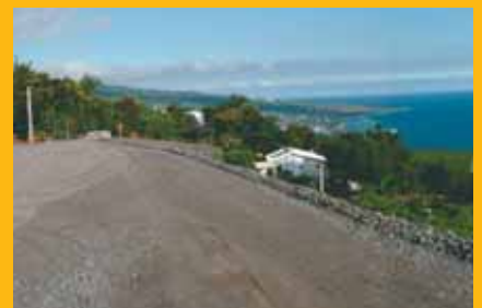
Le chantier de la route des Tamarins au-dessus de la pointe des Châteaux.
